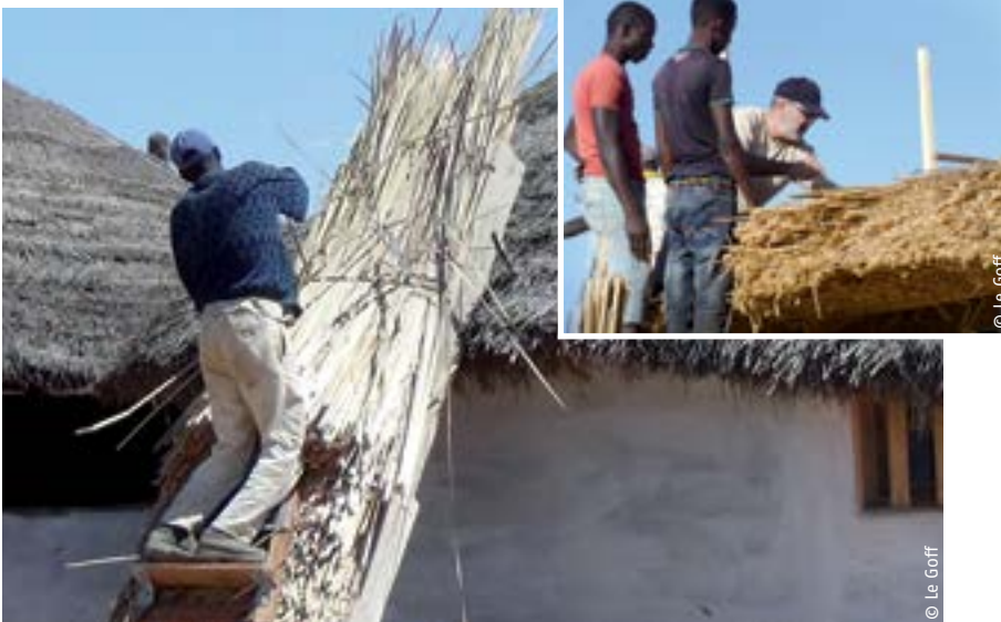
L'entreprise Le Goff forme 10 personnes à la fabrication de toit de chaume en typha .
